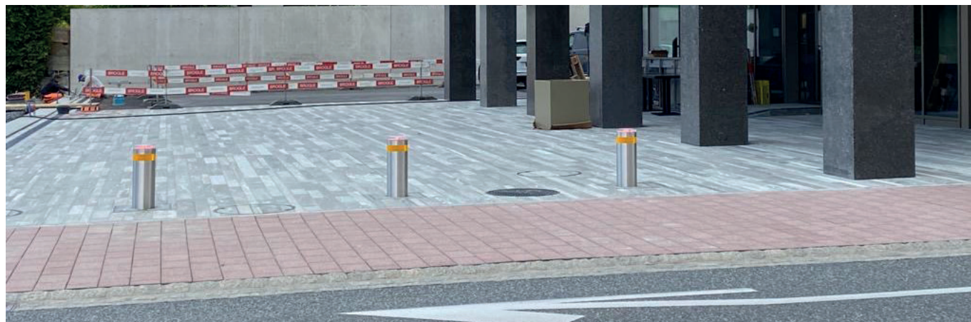
3× Dissuasore retrattile 2, Edificio per uffici
